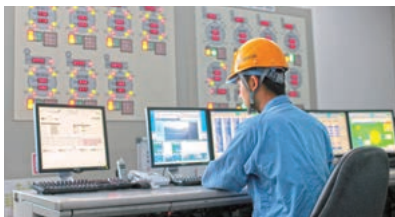
24 小时不间断的中央控制系统
