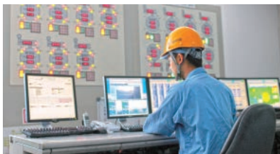
24 小时不间断的中央控制系统
